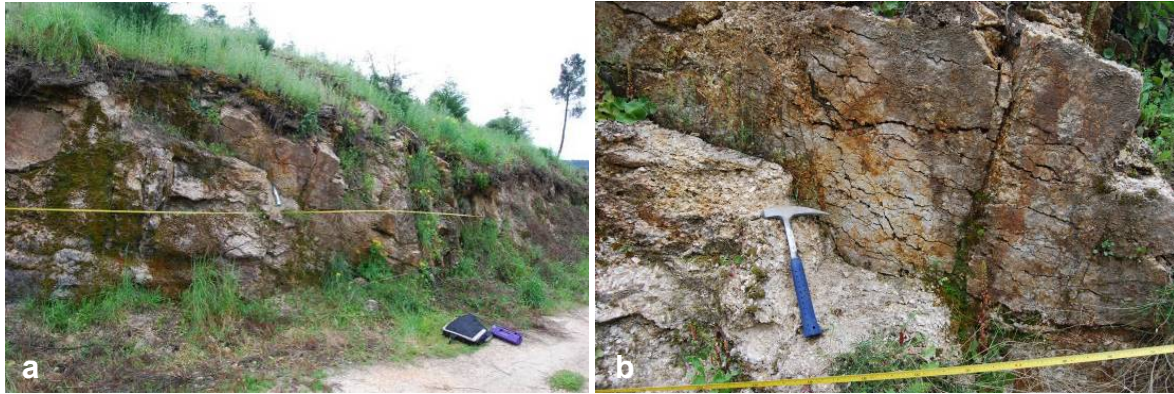
Figura 95 – Aspecto do maciço alterado no Talude da Capela (a), e aspecto de pormenor de um plano de falha ainda bem visível na matriz alterada do maciço (b).
