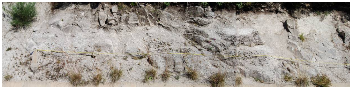
Figura 196 – Aspectos da alteração do maciço e dos planos de falha registados no painel 6. Quadro 40 - Resumo estatístico dos principais parâmetros geológicos e geomecânicos do Painel 6.
