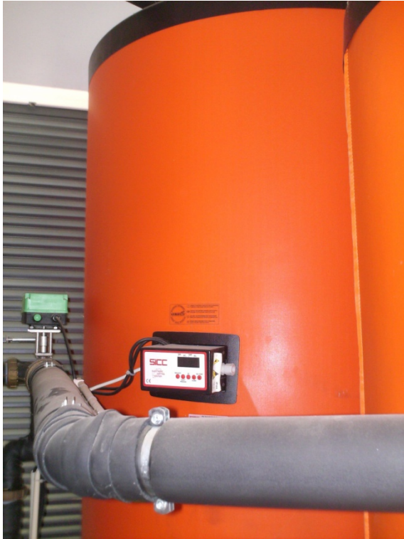
Figura 43. Depósito de água Fria
