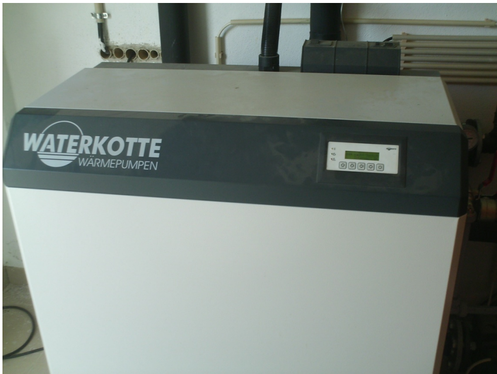
Figura 39. Bomba de calor geotérmico
