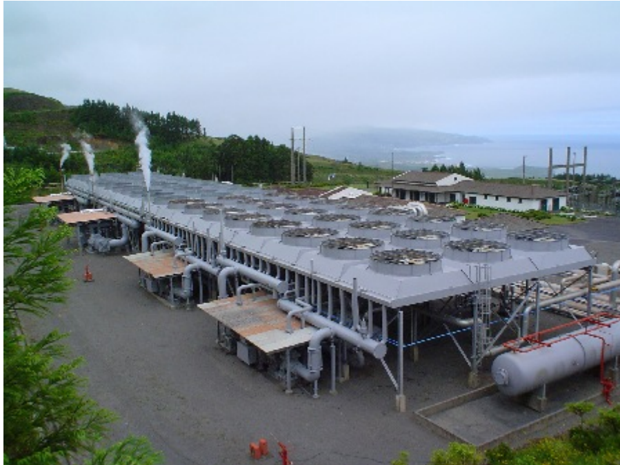
Figura 15. Central de energia geotérmica de Ribeira Grande (Açores). (Fonte - http://cm-ribeiragrande.azoresdigital.pt/ )
