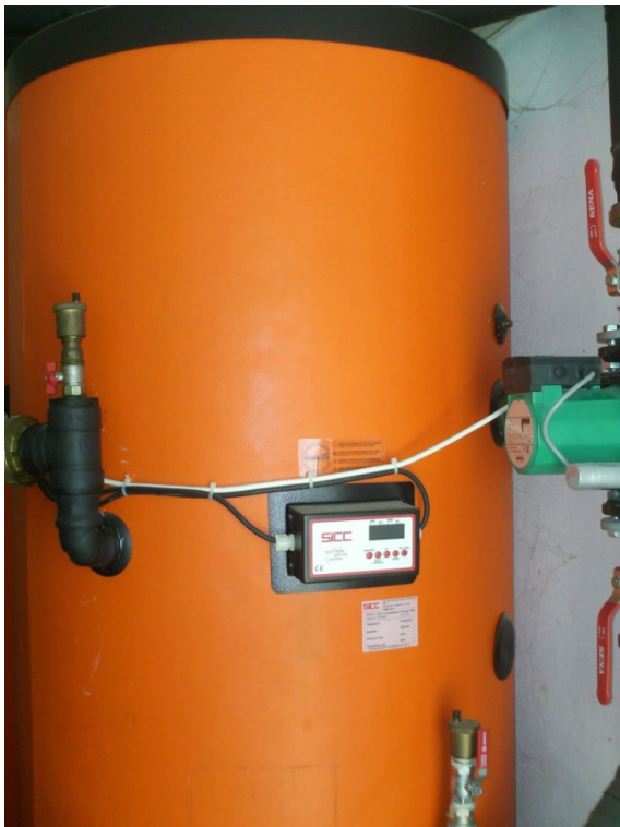
Figura 44. Depósito de água quente
