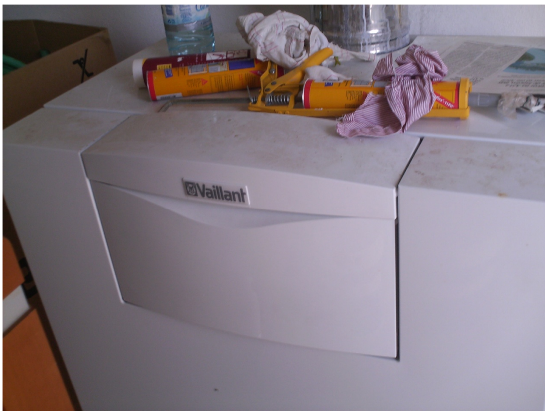
Figura 51. Caldeira a gás
