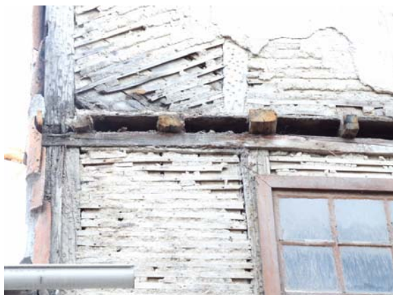
Figura 3.a - Detalhe construtivo de uma parede de Tabique de uma construção em Chaves
