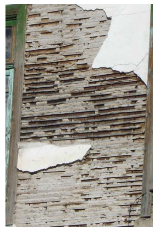
Figura 3.b - Detalhe construtivo de uma parede de Tabique de uma construção em Mirandela
