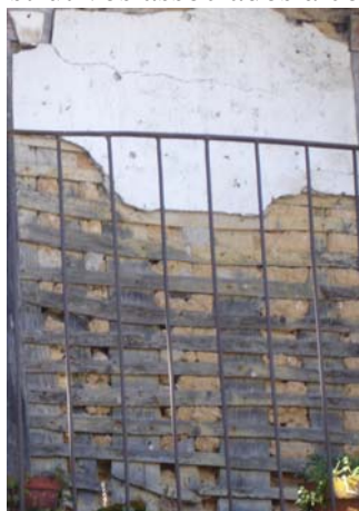
Figura 15-a: Detalhe construtivo de uma parede de Tabique de uma construção em Tabuaço
