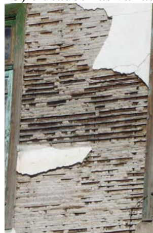
Figura 15-b: Detalhe construtivo de uma parede de Tabique de uma construção em Mirandela
