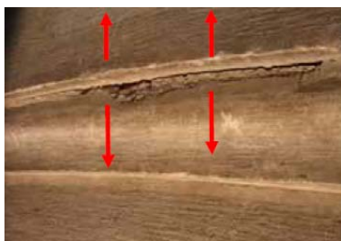
Figura 4: Abertura de junta entre os arcos interior e exterior
