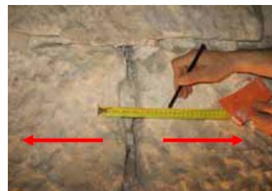
Figura 5: Abertura de junta nas pedras do desvão
