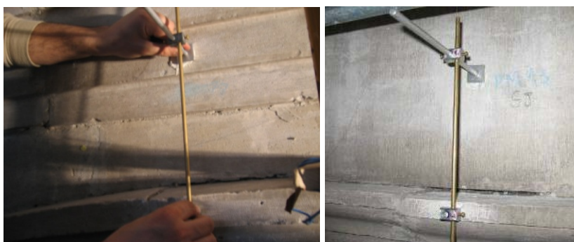
Figura 9: Exemplo de aplicação dos sensores de fibra óptica
