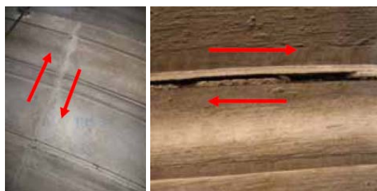
Figura 6: Escorregamento entre pedras do arco
