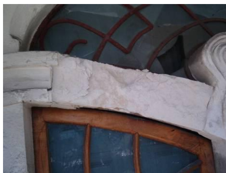
Fig. 18 – Avançado estado de degradação da pedra calcária sobre a porta de entrada na fachada principal [Varum, H. et al; 2008]
