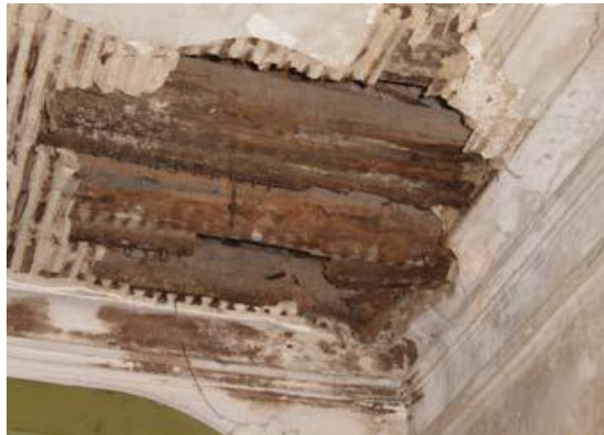
Fig. 15 – Deterioração das vigas de madeira de pavimento [Varum, H. et al; 2005]
