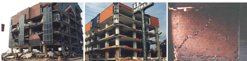
Figura 7: Danos em paredes de alvenaria
