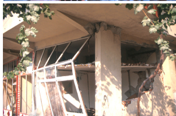
Figura 5: Rotura em pilares por flexão [22]
