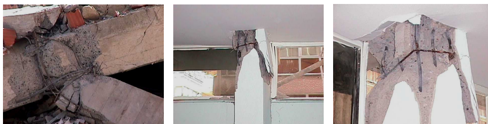
Figura 4: Pormenorização deficiente das armaduras [21]
