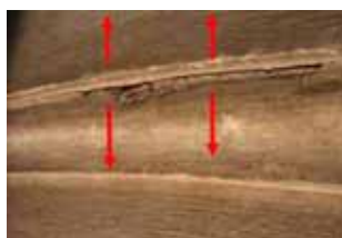
Fig. 4 – Abertura de junta entre os arcos interior e exterior
