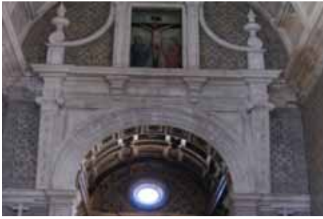
Fig 9 – Aspecto final do Arco-Cruzeiro após instalação do sistema de monitorização
