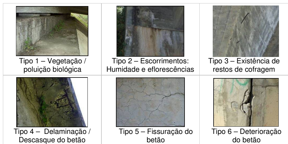
Figura 7. Exemplos de patologias em Obras de Arte de betão armado.
