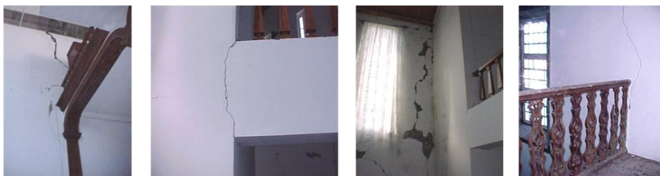
Figura 3: Danos resultantes da interacção entre coro alto e paredes laterais [Costa e Vasconcelos, 1999]
