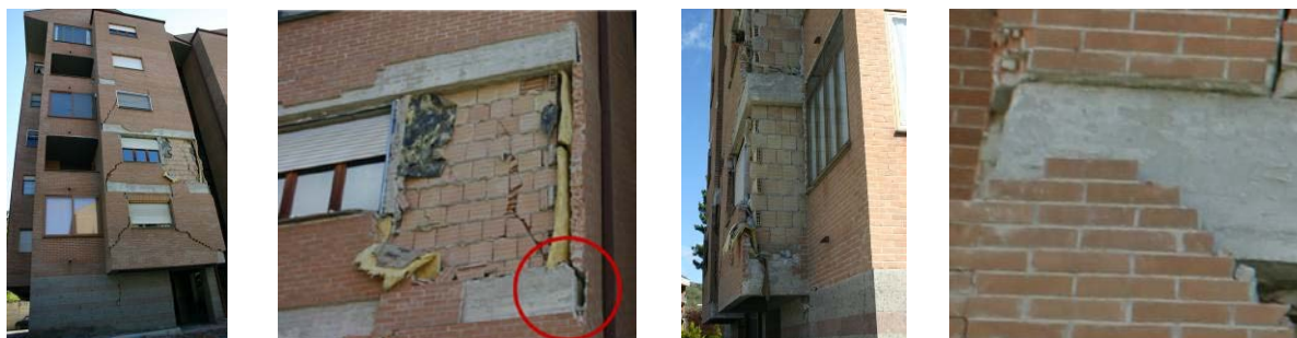
Figura 13: Danos em painéis de alvenaria de enchimento
