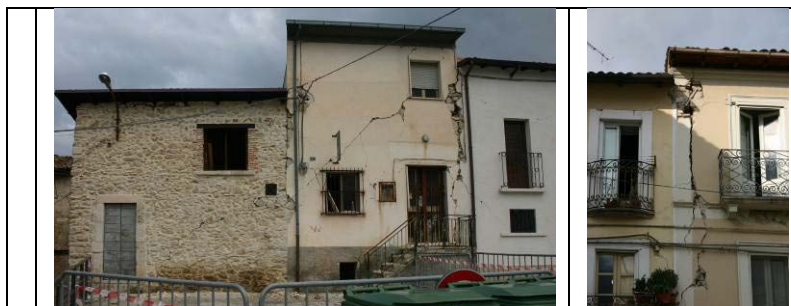
Figura 22: Danos associados ao comportamento em agregado de diferentes edifícios
