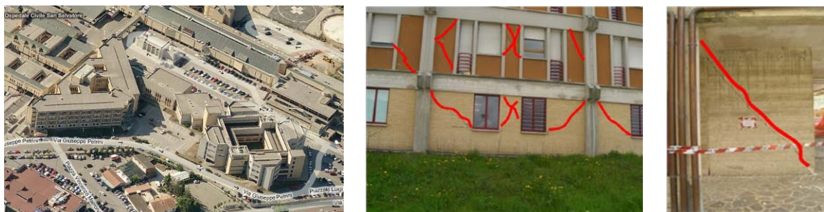
Figura 18: Hospital San Salvatore: a) vista geral, b) danos em painéis de alvenaria; c) danos em paredes de betão armado
