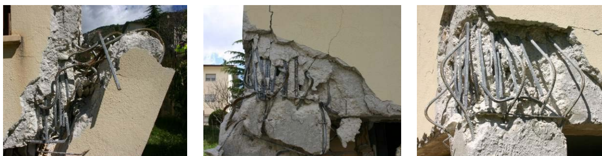
Figura 15: Danos em nós de elementos de betão armado
