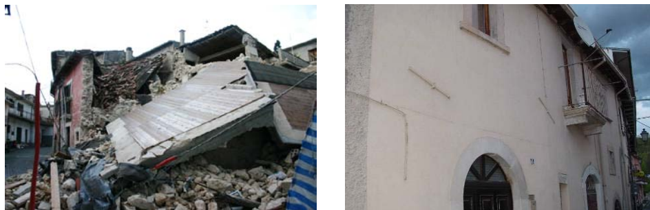
Figura 9: Danos em estruturas de alvenaria: a) utilização de pisos de betão armado; b) eficiência da utilização de tirantes
