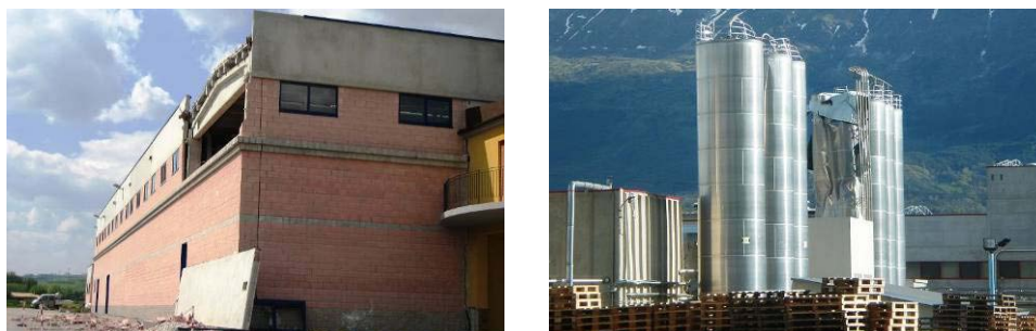
Figura 11: Zona Industrial de Bazzano: a) queda de fachadas de painéis em betão pré-fabricado; b) colapso de silos metálicos
