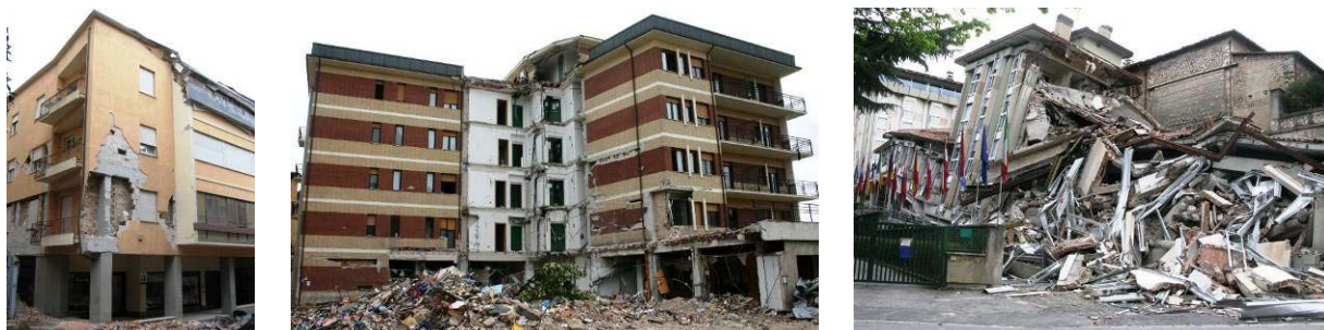
Figura 6: Danos em estruturas de betão armado no centro de L'Aquila
