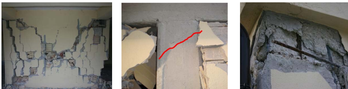
Figura 17: Danos estruturais no edifício PAG04: a) dano em painel de alvenaria de enchimento no plano; b) rotura por corte dum pilar curto; c) insuficiências de comprimento de amarração num nó de betão armado.
