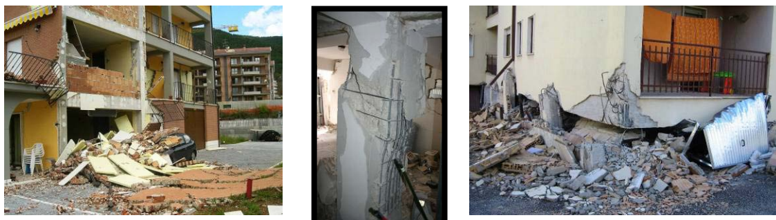
Figura 7: Danos em estruturas de betão armado
