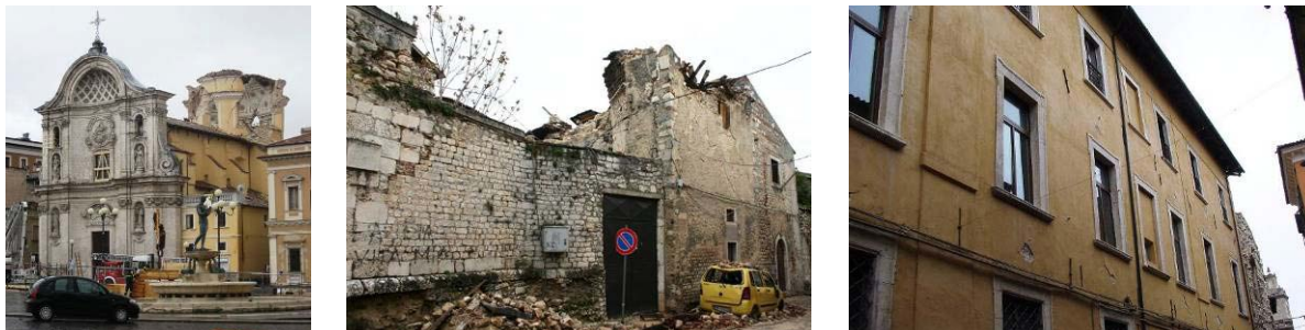
Figura 5: Danos em estruturas de alvenaria tradicional no centro de L'Aquila
