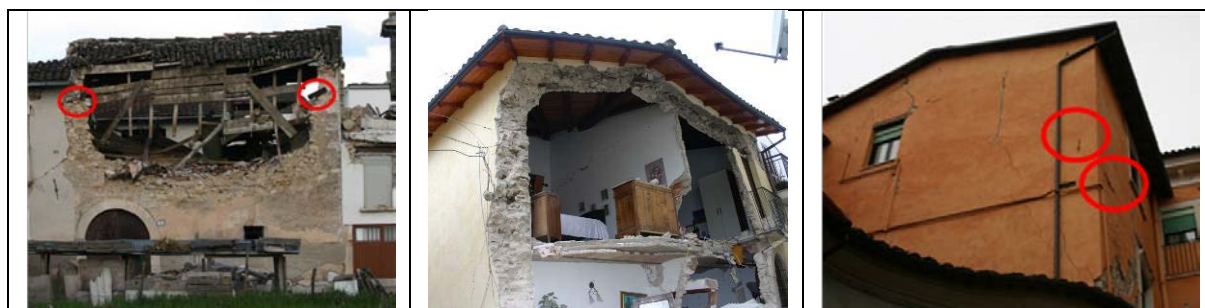
Figura 21: a) e b) Colapso de paredes fora do plano; c) eficiente utilização de tirantes
