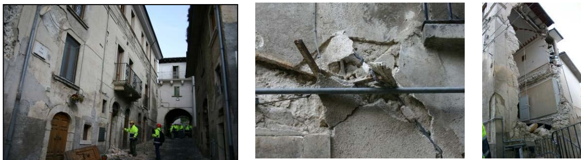
Figura 24: Colapso de um edifício de habitação de alvenaria em Fossa
