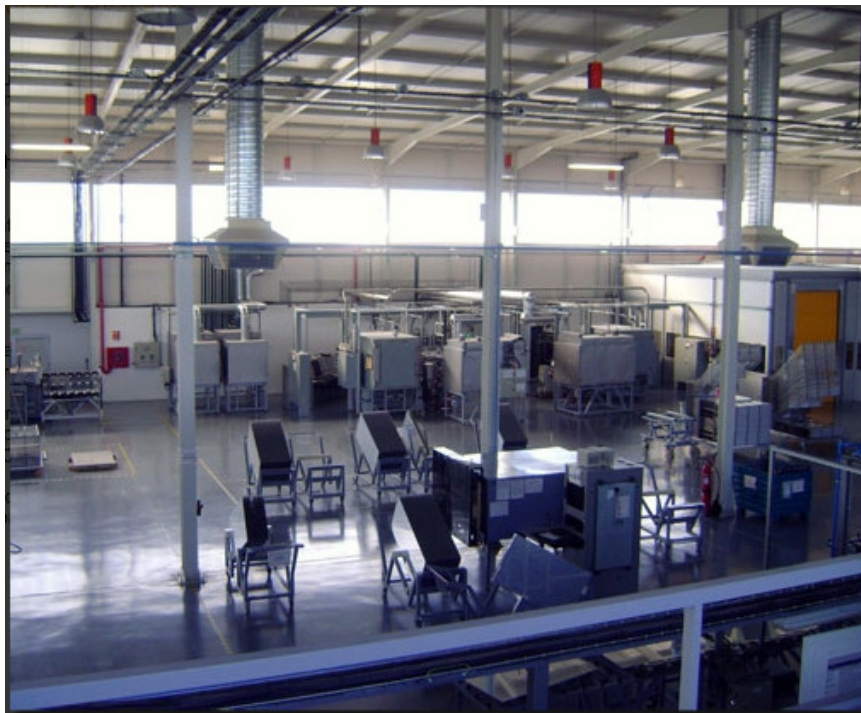
Fotografia 4 - Interior da nave fabril - Teste de painel e deposição
