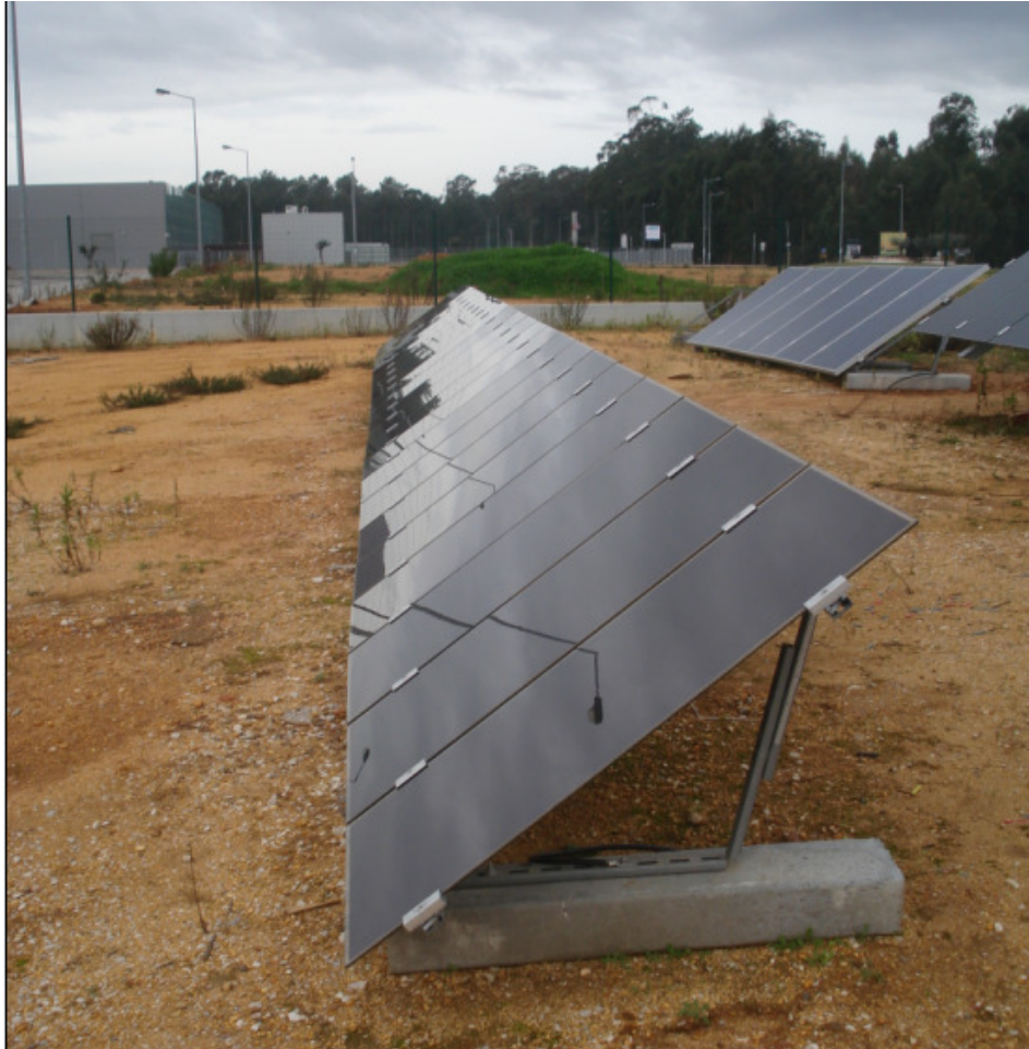
Fotografia 5 - Pequena central fotovoltaica em testes no recinto da empresa
