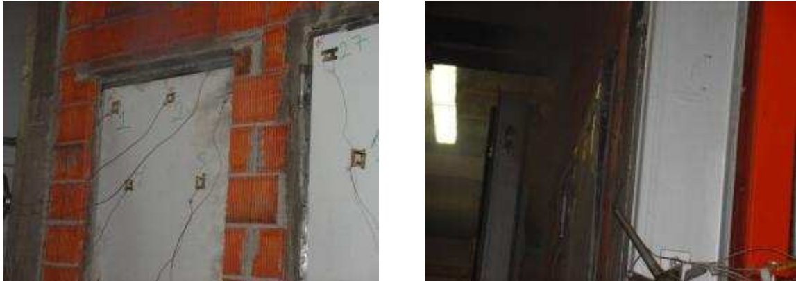
Figura 3-11 Presença de fumo na porta A e deformação da porta B decorridos 3 minutos no ensaio.
