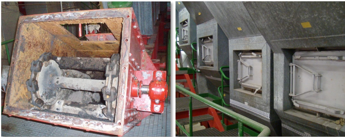
Figura 1.12 – Interior do transportador de arrasto (esquerda) e tremonhas de escórias finas situadas abaixo da grelha de rolos e acima do transportador de arraste (direita).
