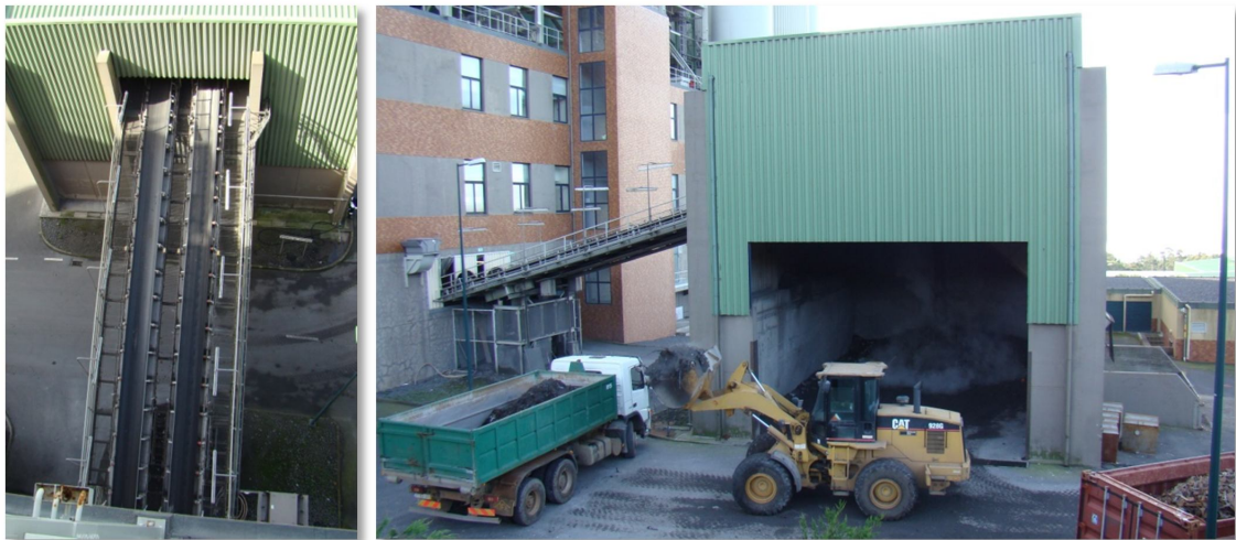
Figura 1.15 – Correias transportadoras (esquerda), edifício de escórias e transporte para aterro de escórias (direita).
