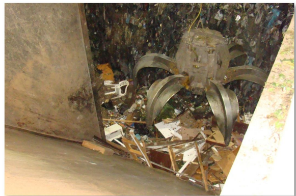
Figura 1.5 – Garra da fossa de resíduos.
