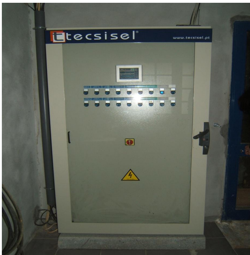
FIGURA 11- EQUIPAMENTO DE CONTROLO DA UTILIZAÇÃO DA ENERGIA
