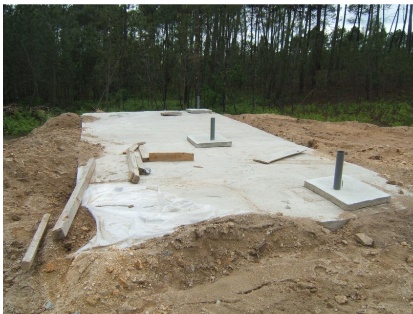
FIGURA 12 – FOSSA ESTANQUE PARA ONDE VAI A ÁGUA DA LAVAGEM DO PAVILHÃO
