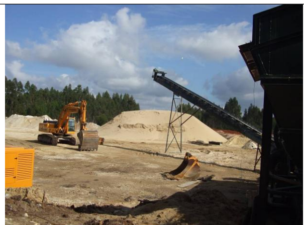
Figura 5.7 - Equipamento para a crivagem da areia
