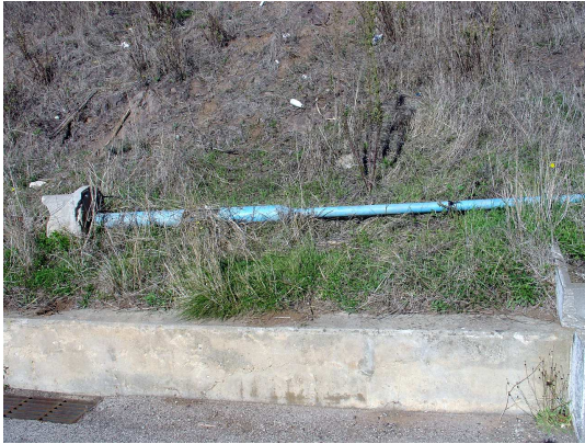
Est. I-1: Candeeiro caído devido a deslizamento de terreno – Paragem 1.
