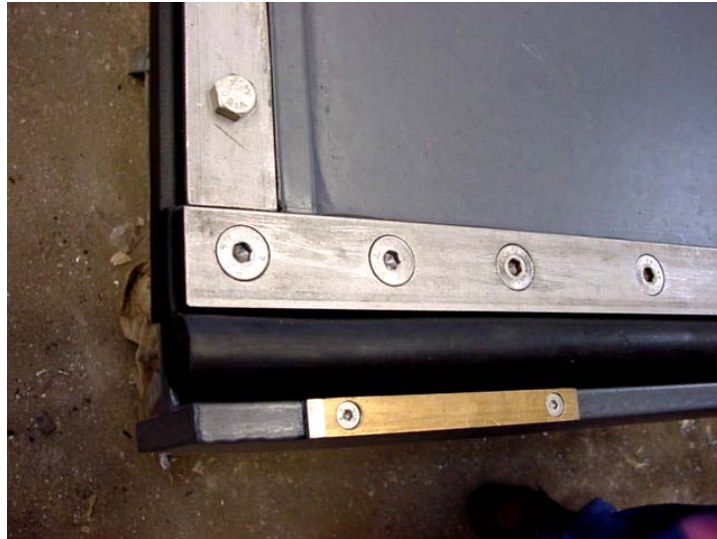
Figura 15 – Pormenor de vedação de comporta ensecadeira instalada na Estação Elevatória de Aravil, no Aproveitamento Hidroagrícola de Idanha-a-Nova.
