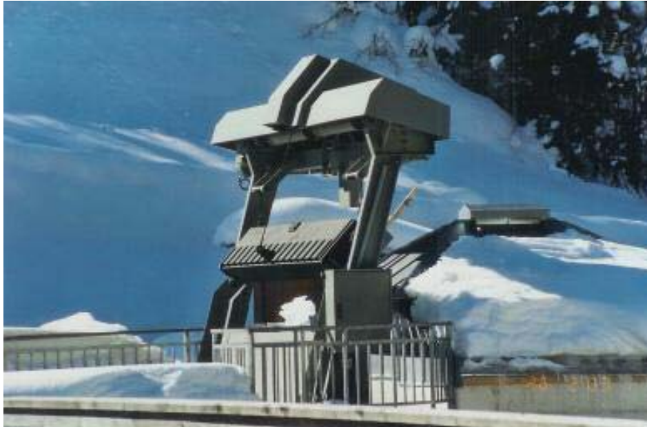
Figura 6 – Descolmatador de accionamento por cabo instalado na Central Hídrica de Reutte [2].
