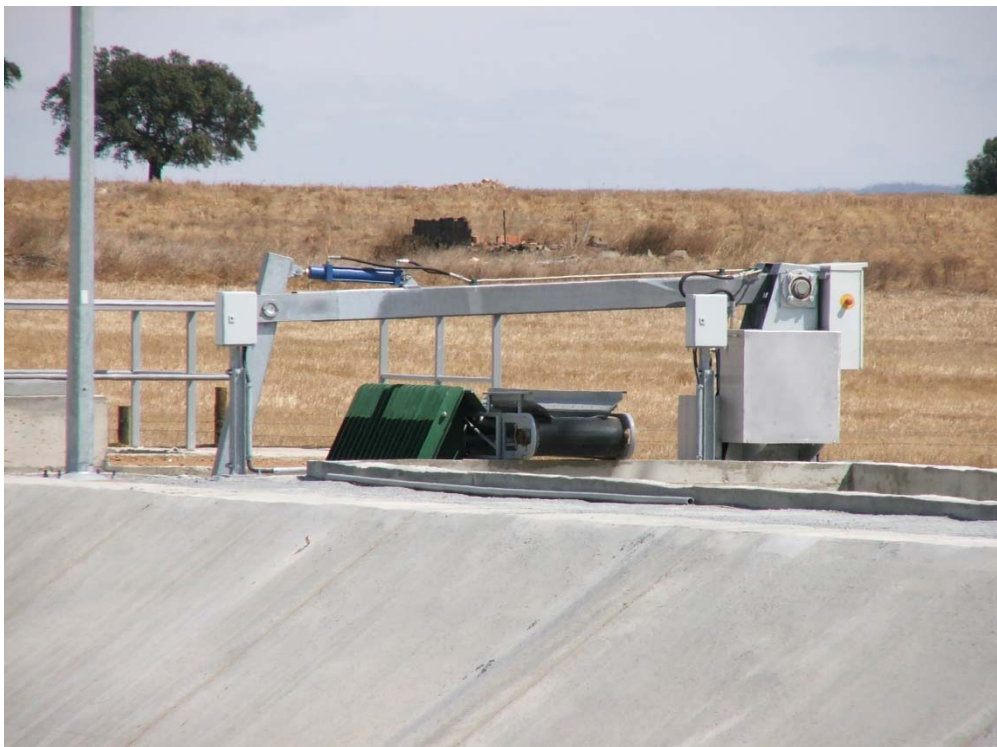
Figura 2 – Descolmatador instalado na derivação para o Reservatório de Faro do Alentejo.
