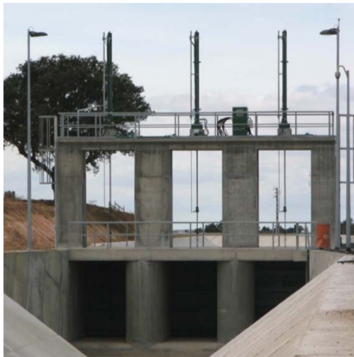
Figura 11 – Comportas vagão de dimensões 2000x3000 [mm 2 ] instaladas no canal Alvito-Pisão.
