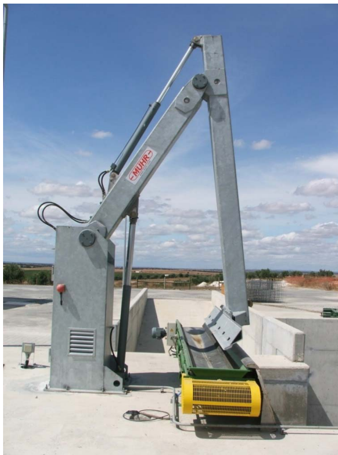
Figura 5 – Descolmatador com transportador de detritos associado, instalado na tomada de água da Albufeira do Pisão.
