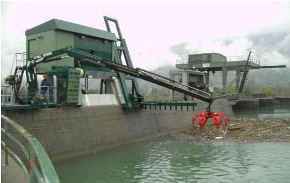
Figura 9 – Equipamento auxiliar do descolmatador móvel de accionamento por cabo instalado na Central Hídrica de Feistritz [2].
