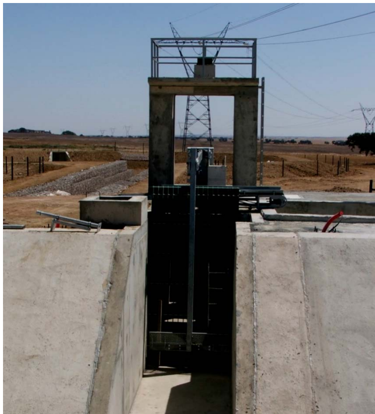
Figura 1 – Descolmatador instalado na derivação para o Reservatório de Faro do Alentejo.
