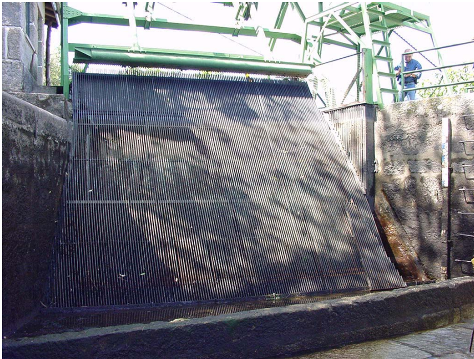
Figura 16 – Grelha fixa instalada na câmara de carga da Central Hidroelétrica de Aregos (EDP Douro), com espaçamento entre barras de 20 mm.
