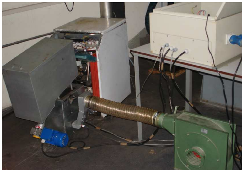
Figura 32. Queimador de pellets e caldeira a gasóleo.
