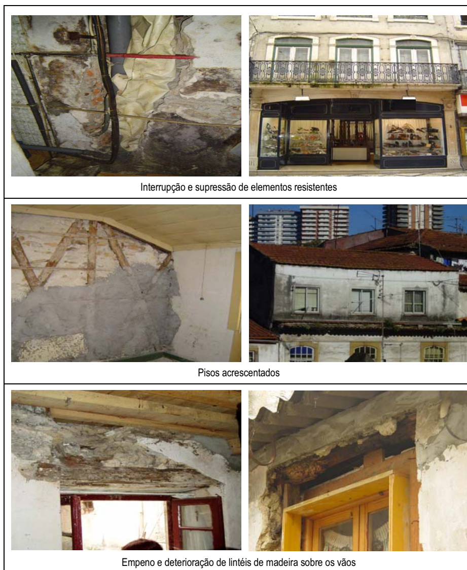
Figura 103: Exemplos de outros problemas em paredes de fachada em alvenaria
