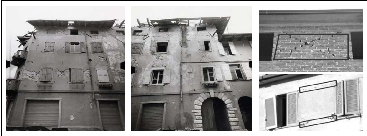
Figura 268: Danos no plano das paredes de alvenaria [Galasco, 2005; Lagomarsino, 2007]
