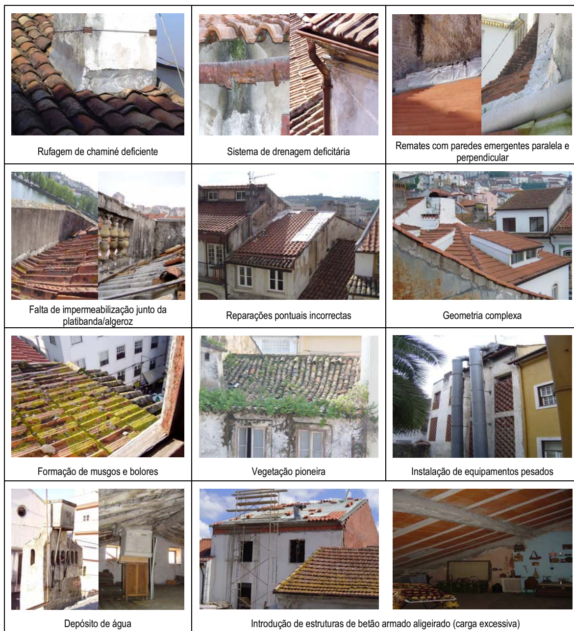
Figura 129: Outras anomalias das coberturas
