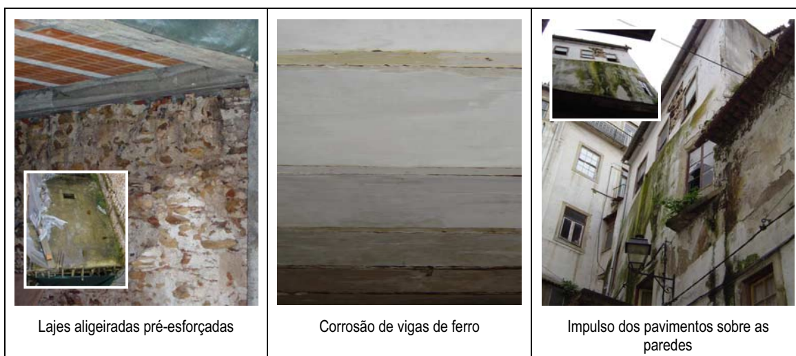
Figura 116: Outros problemas dos pavimentos de madeira
