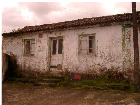
Fig. 5. 5 Furnas, Travessa entre os n.º 29 e 37 da Rua das Águas Quentes, n.º 31 – Habitação
