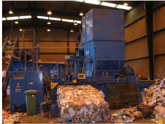
Figura 3-5 Enfardadora/compactadora dos materiais triados.
