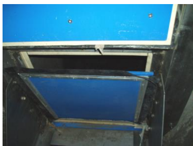
Figure 5 - Fermeture incomplète du Déomatic®
