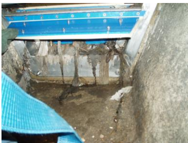
Figure 3 - Présence de déchets au niveau de la partie basse du Déomatic®
