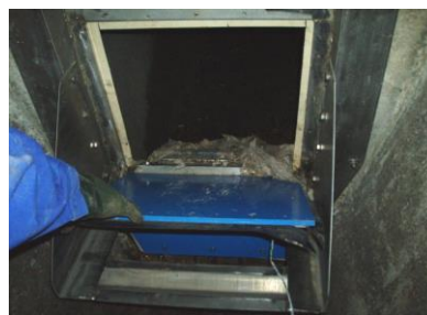
Figure 4 - Présence de déchets au niveau de l'axe bascule du Déomatic®
