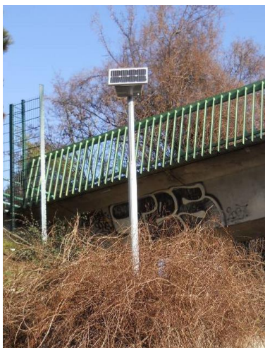
Figure 9 - Panneau solaire permettant l'alimentation électrique du dispositif vidéo
