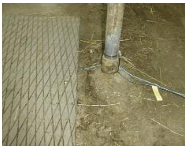
Figure 1 : La mise en place d'un enregistreur permanent est une technique lourde mais très performante : la figure montre les connexions à réaliser (Cliché F. Gallouin).
