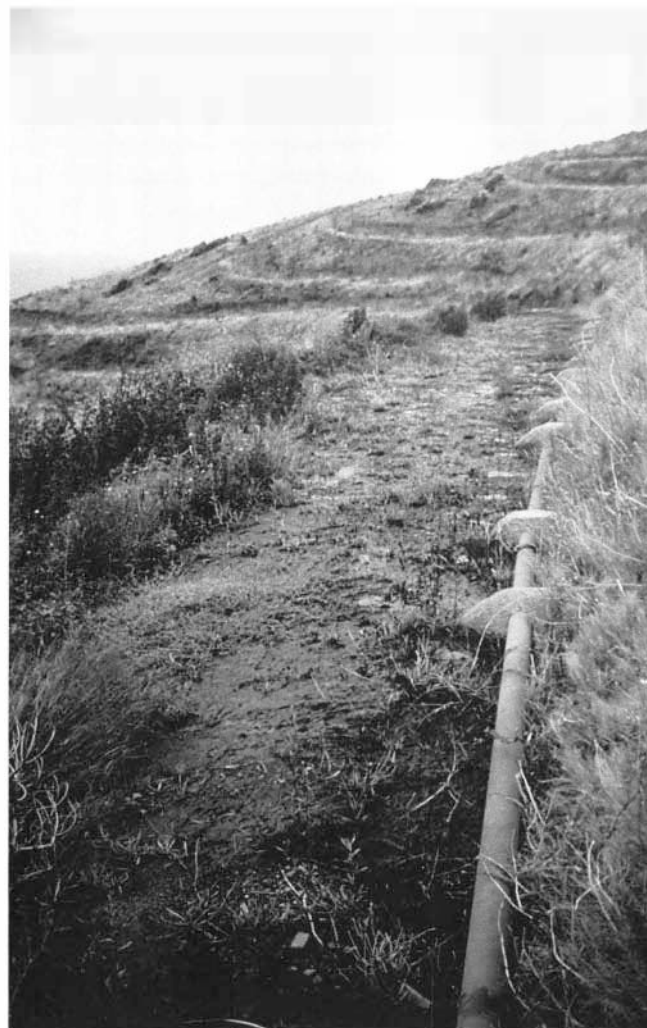
Photo 3 : Système d'épandage gravitaire des eaux usées épurées à partir d'une canalisation en fonte (anti-incendies) sur la commune de Cerbère (66).
