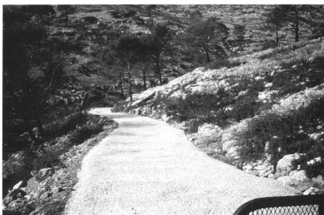
Photo 15 : Piste bétonnée mettant en évidence les rebords irréguliers épousant le relief naturel Photo J.Gourc
