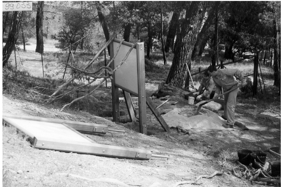
Photo 4 : Installation d'un panneau support de signalétique - Sainte Victoire Photo SIVU Sainte Victoire
