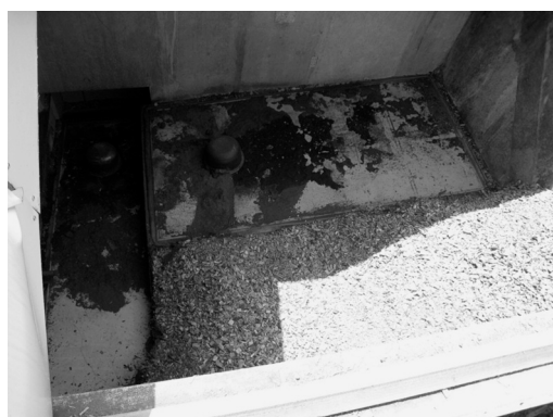
Photos 3 et 4 : Vue du bâtiment abritant la chaudière des HLM de Cendras (Gard) et intérieur du silo Photos DA
