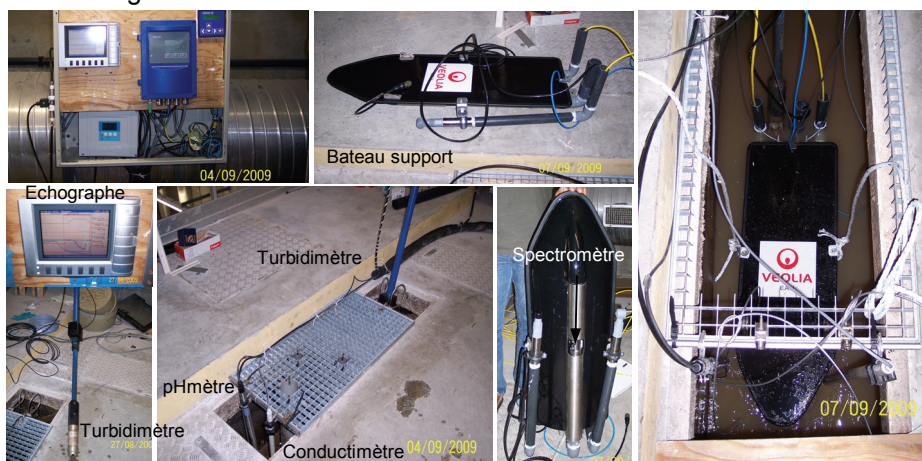
Figure 2 : Station de mesure en continu des polluants en entrée de l'usine de dépollution
