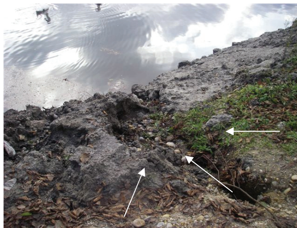
Figure 3 : bassin de Bourran – dégradations consécutives aux ruissellements non canalisé
