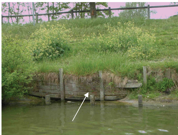
Figure 2 : bassin de Chambéry – dégradations des liernes (avant travaux)
