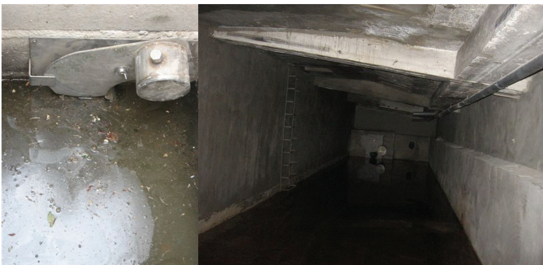
Régulateur à flotteur – axe bloqué par l'installateur / Bassin de stockage régulation – régulateur inaccessible en cas de blocage bassin plein
