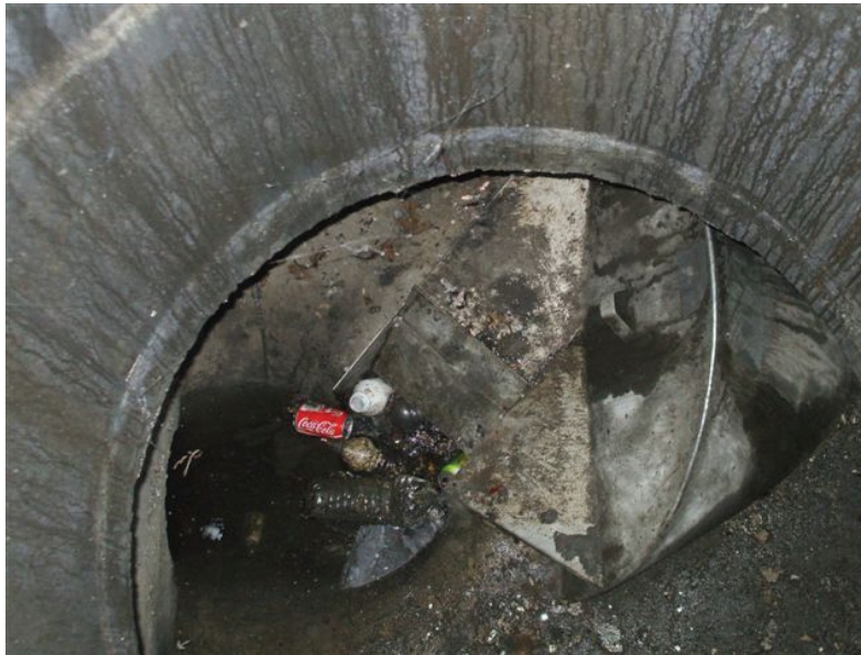
Régulateur de débit non entretenu
