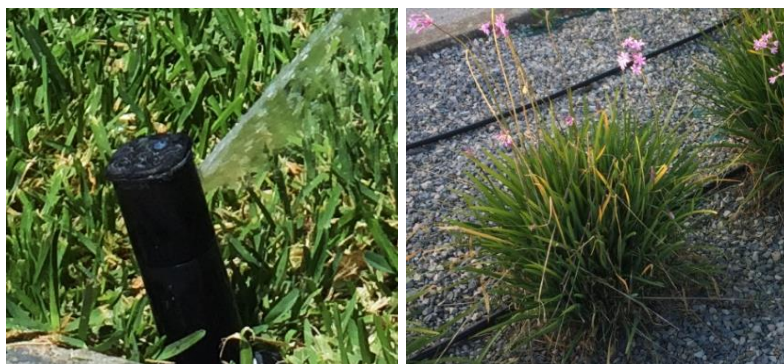
Figura 3.9 – Aspersor Rain Bird Série 5000 rotor e tubagem com gotejadores, respetivamente (Fonte: autora).
