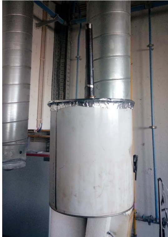
Figura 3.12- Vaso de expansão da instalação.
