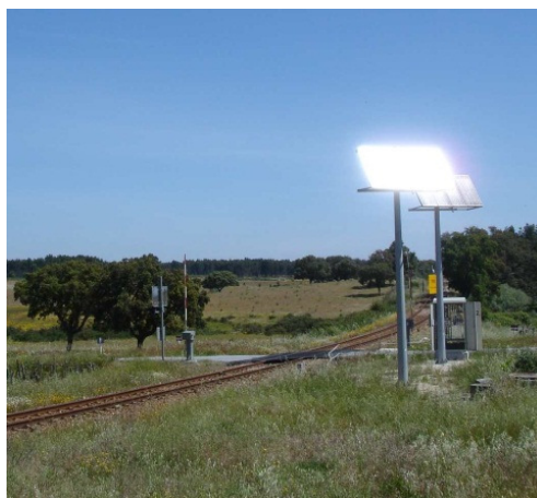
Fig. 3.15 – Automatização da PN ao Km 223,308 da Linha do Leste
