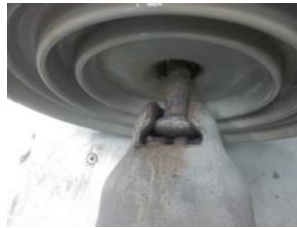
Figura 2.7 - Conexão campânula e espigão numa cadeia de isoladores [22]
