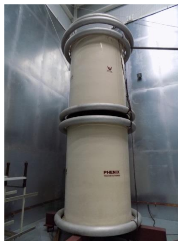
Figura 6.5 - Transformador Phenix de 300kVA
