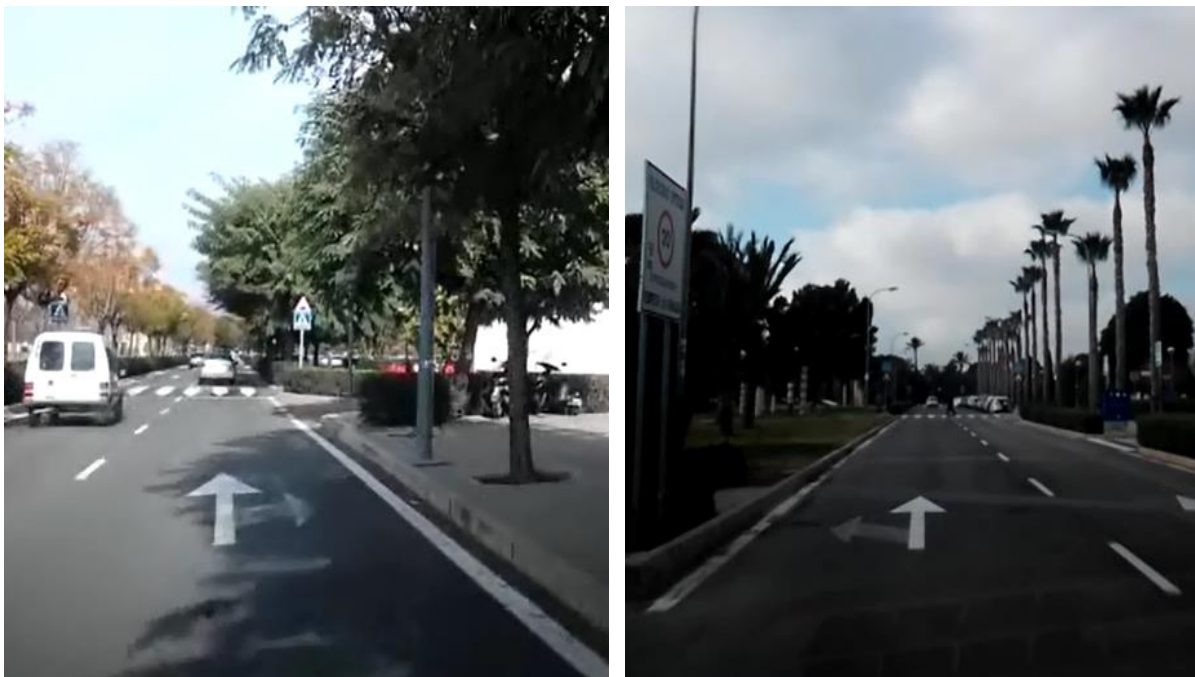
Figura 78. Marcas viales confusas en el campus de la UA. Elaboración propia.
