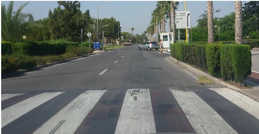
Figura 103. Desgaste en calzada. Elaboración propia.
