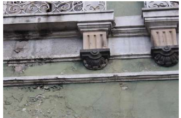
Figura 96. Fotografía de daños, vista Fachada Norte
