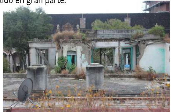
Figura 94. Fotografía de daños, vista Fachada Norte
