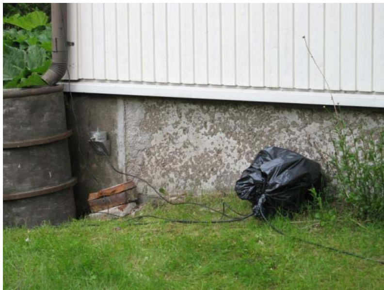
Kuva 6.4. Eräs mittari ja anturi asennettuna talon sokkeliin (Kalliotekniikka 2009, s. 5).
