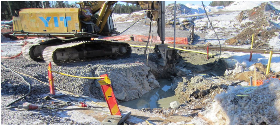
Kuva 26: Tuoreella paluulietteellä täyttynyt kaivanto.
