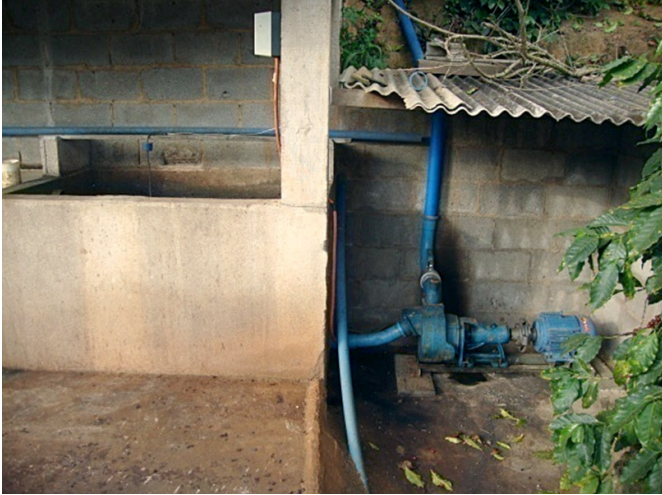
Figura 21. Bombeamento da caixa de decantação para reúso.
