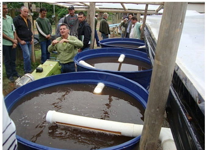
Figura 24. Caixas de decantação do Sistema de Limpeza de Águas Residuárias (SLAR).
