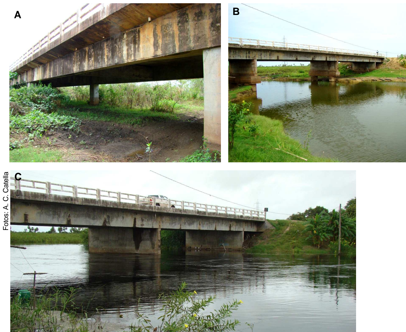
Figura 8. Áreas que podem ser utilizadas pela fauna sob as pontes de vazante na BR-262 no Pantanal durante o período de seca (A e B), destacando as marcas do nível d'água nas pilastras no período de cheias (setas). (C) ponte no período da cheia.
