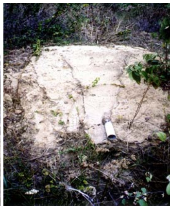
Fig. 7. Dreno subterrâneo, lote 27.
