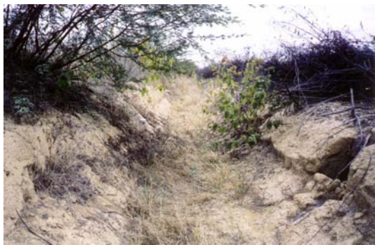
Fig. 6. Dreno coletor secundário, lote 27.
