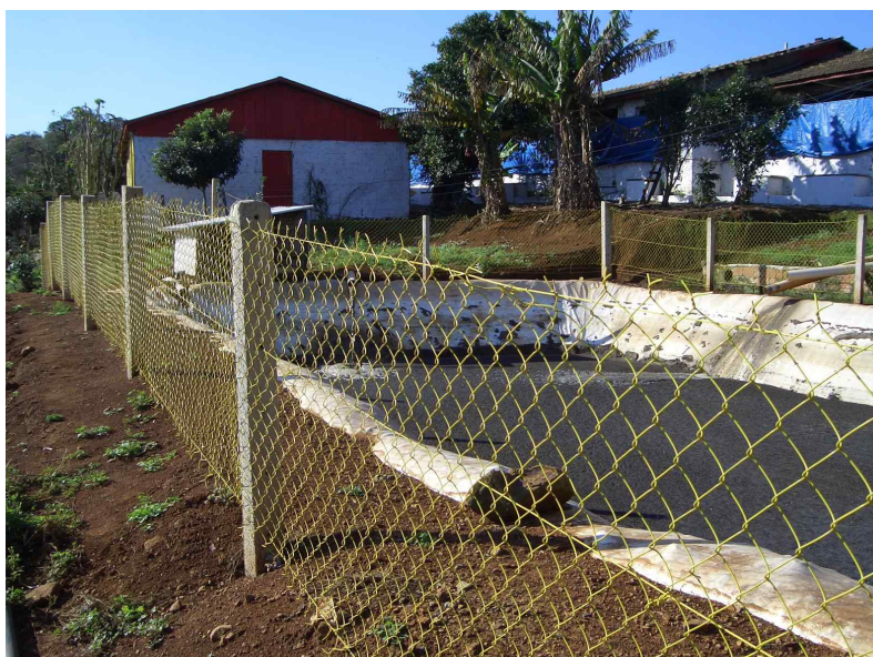
Fig. 9 - Esterqueira instalada pelo PNMA II em propriedade para armazenamento dos dejetos gerados na produção de suínos.
