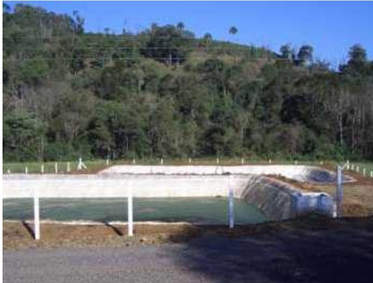
Fig. 14 - Esterqueiras implantadas pelo PNMA II, considerando os aspectos construtivos e a estabilidade dos taludes.
