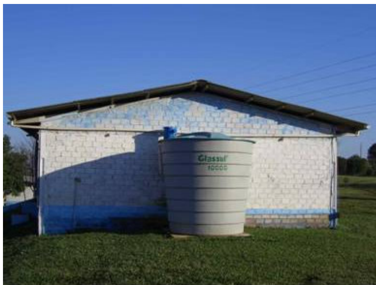
Fig. 7 - Cisterna instalada pelo PNMA II, para aproveitamento da água da chuva.
