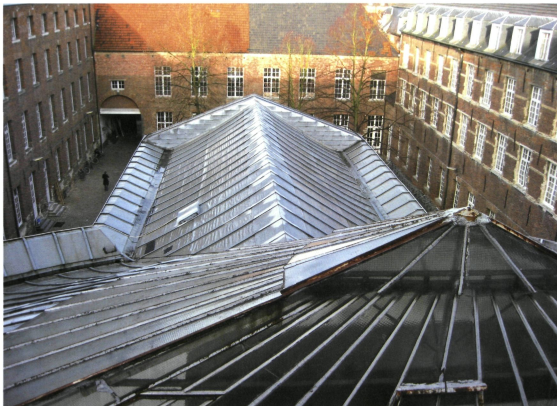
Het zinken dak van de Grote Aula in 2010, vlak vóór de restauratie (foto Technische Diensten KU Leuven)
