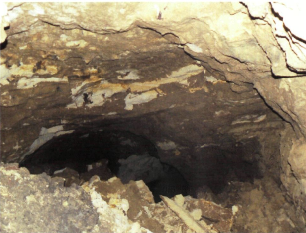
Een lek in de waterleiding veroorzaakte aan de Luikersteenweg in Vreeren (Tongeren) een instorting waardoor een aacht werd ontdekt (foto's P. Van den Hove)
