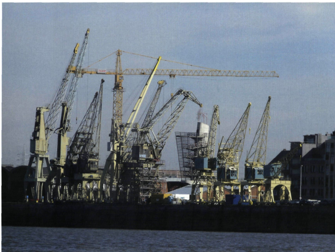
De Antwerpse havenkranen aan de Rijnkaai in volle restauratiecampagne, met op de achtergrond de werken aan het Red Star Line museum, foto genomen vanop de sleepboot Odilia, 2012 (foto M. Van Dijck)
