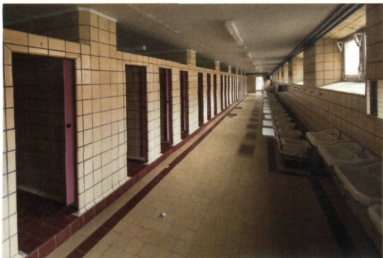
In de jaren 1930 werd een stortbad-kamer in de onderverdieping aangelegd (foto O. Pauwels)
