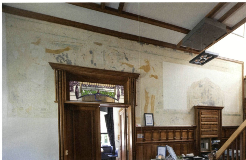
Het sgraffito van de oostwand werd beschadigd door ondeskundig blootleggen (foto O. Pauwels)
