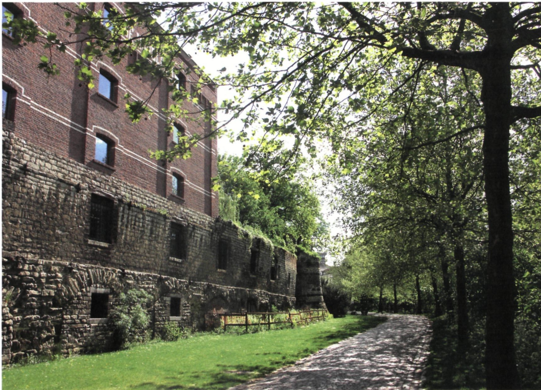
Het Handbooghof in Leuven, toestand in 2004 van het restant van de voormalige romaanse stadsmuur (foto D. Nuytten)
