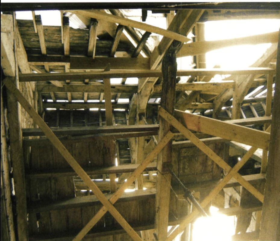
Stabiliteitsproblemen door aantasting van de inwendige houten structuur van het molengebouw (foto D. Nuytten)
