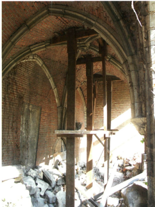
Scheurvorming en vervormingen gelden als alarmsignaal (foto D. Nuytten)
