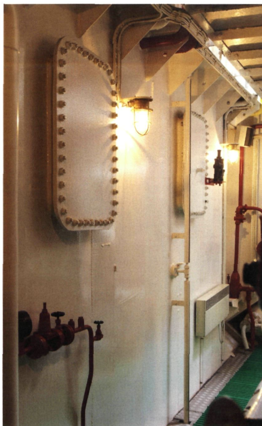
Dieseltank in het motorcompartiment. De Amandine kon in haar drie tanks 55.000 liter diesel bunkeren (© OE, Kris Vandevorst)
