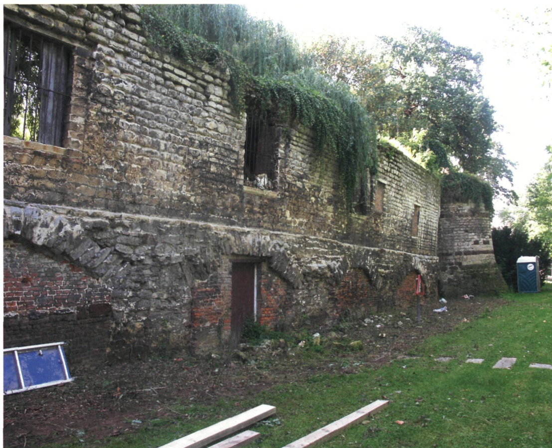
Handbooghof bij de start van de schoringswerken in het najaar van 2006: bemerk de relatieve schiefsstand ten opzichte van de toren (foto D. Nuytten)
