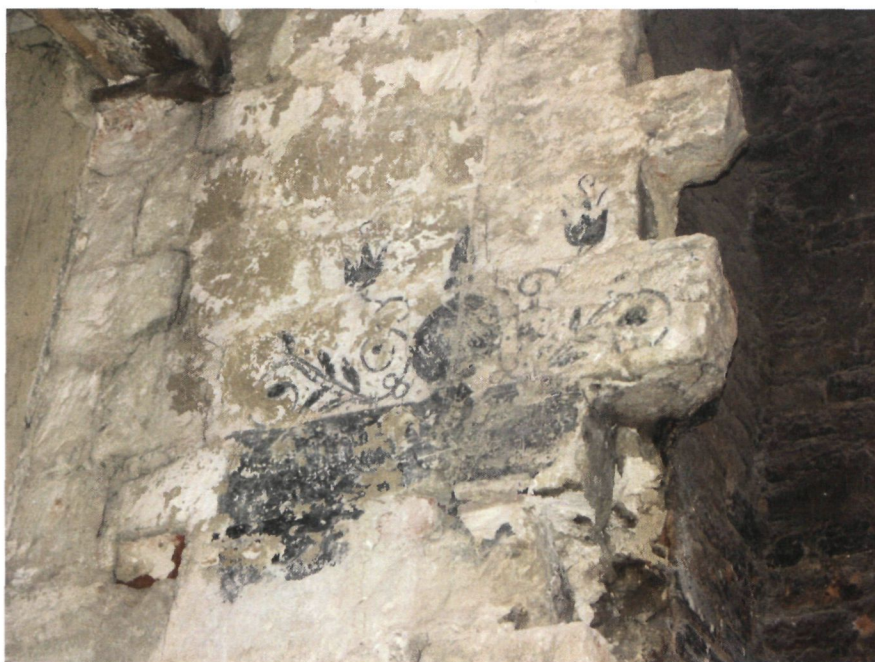
Vrijgelegde decoratieve fries in zwartschildering op de zuidwand van het gelijkvloers (foto D. Nuytten)
