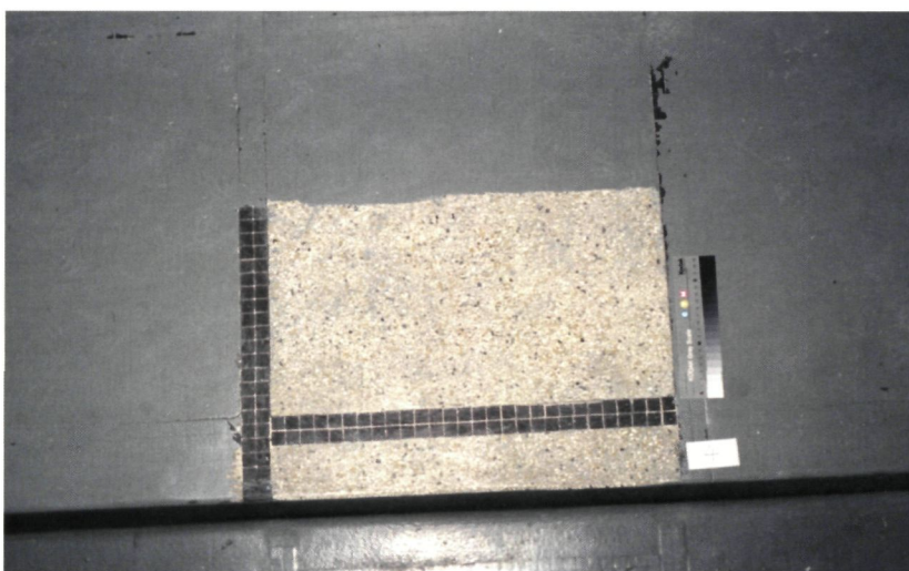
Granito vloer van de tribune onder de epoxy-overschildering van latere datum (foto L. De Clercq)
