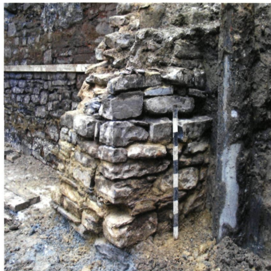
Torenfundering aan de buiten- zijde van de burchtmuur (© Stad Antwerpen, afdeling archeologie)
